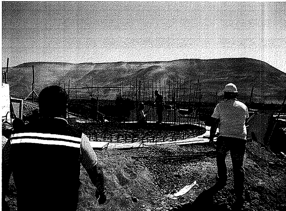
Fotografía 6: Estanque semienterrado, DOH.
